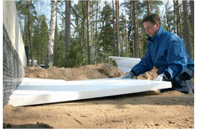
Reuna-alueen eristepaksuutta käyttäen voidaan eristää myös koko alapohjan alue. Tällöin asennusvaihe helpottuu ja nopeutuu.
